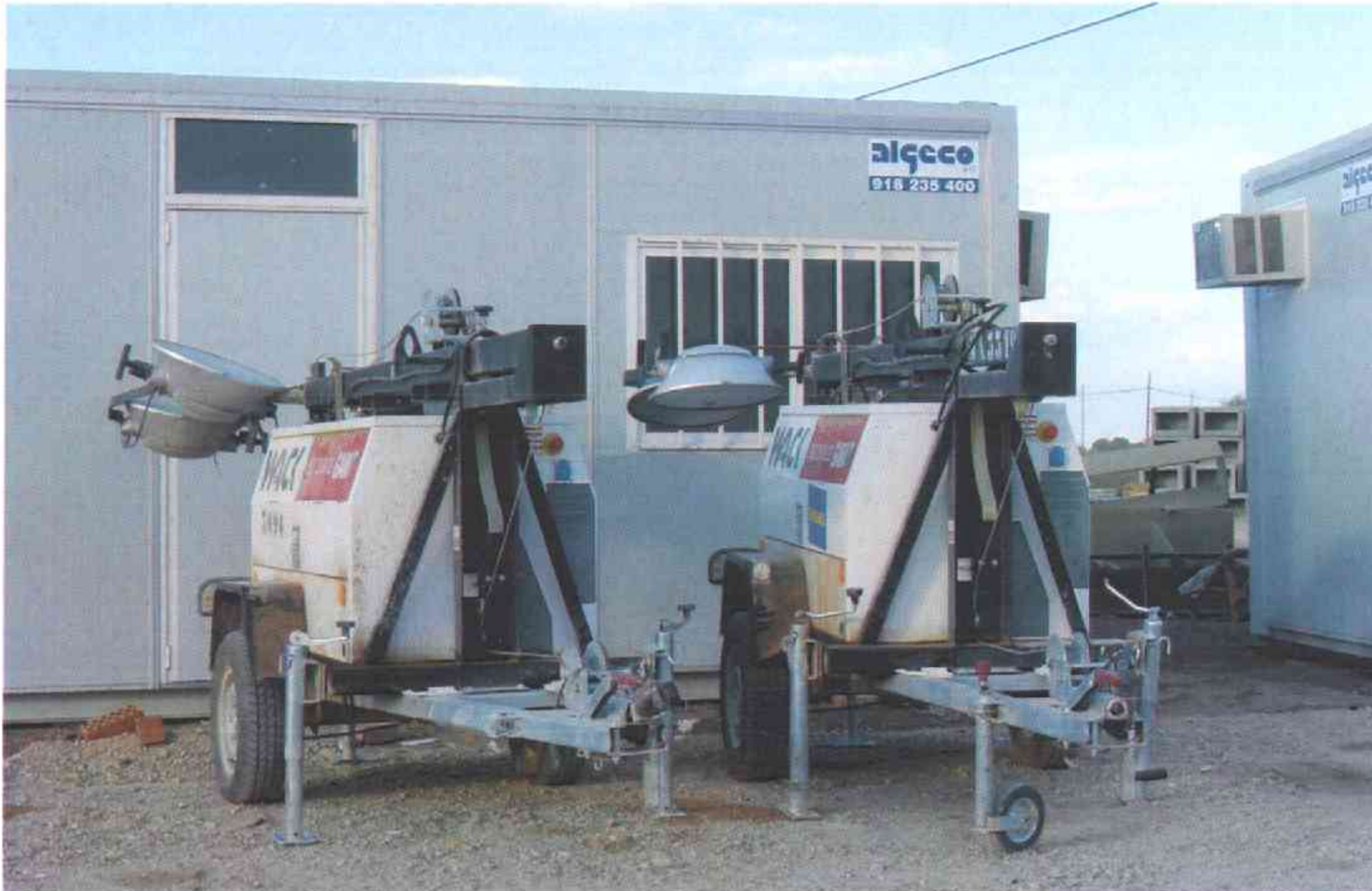
Sistema de iluminación utilizado habitualmente en construcción.
